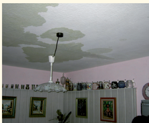
Viel Ärger – Wasserschaden in einer Wohnung
